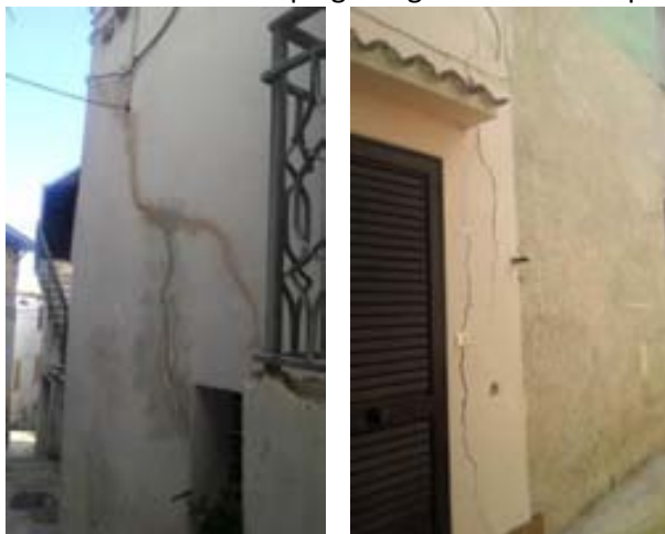
Foto 1: edifici lesionati nel centro abitato di Ripe di mezzo. Con DGR n. 41/2016 l'area è stata inserita nelle perimetrazioni del PAI
